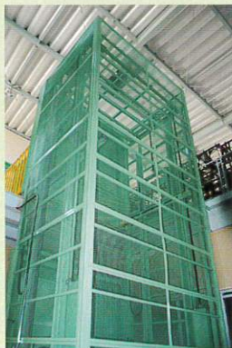
エキスバンドメタル張り昇降路
